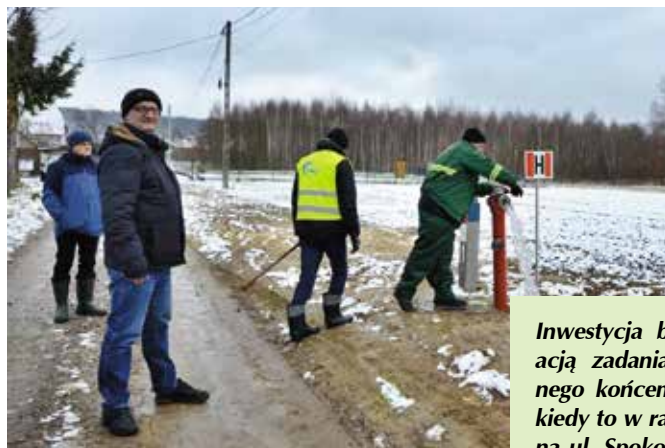
Wodociąg już działa! W odbiorze udział wziął m.in. Piotr Zegadło, przewodniczący Rady Gminy.
